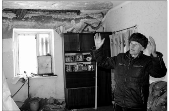
Луганська обл., с. Золоте. Внаслідок обстрілу пошкоджено дах приватного будинку. Хазяїн вимушений був переселитися до сараю для тварин, де проживає й тепер
